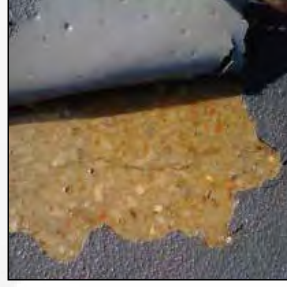
Astarın üzerinde sı yalıtımı geç yapılması ile oluşan yapışma zafiyeti
