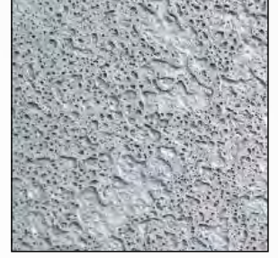
Alt yüzey hazırlığı düzgün yapılmamış yüzeyde ki hata
